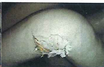
エルボ部に使用 石綿含有保温材
