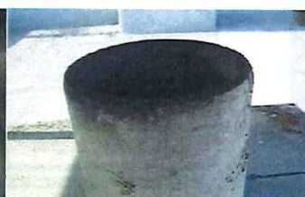
煙突の内側に使用 石綿含有断熱材
